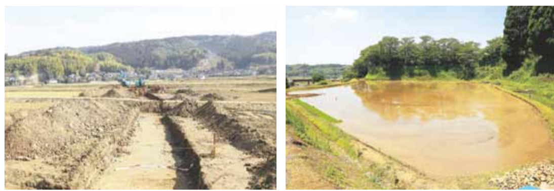
プロジェクトによる早急な工事で復旧した益城町の水田
