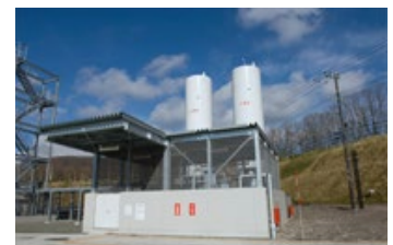
サントリープロダクツ（株）天然水奥大山 ブナの森工場の液化天然ガス施設
