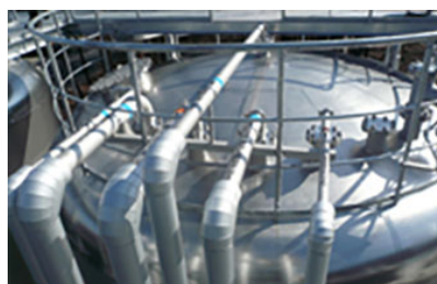
清浄レベルごとに回収した水を 200tのタンクに貯蔵し再利用
