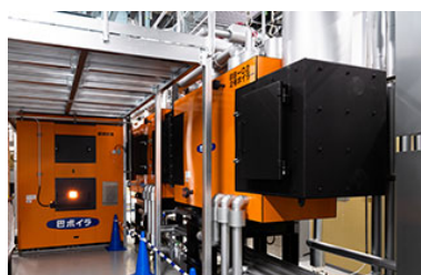
バイオマスボイラー (サントリー天然水 北アルプス信濃の森工場)
