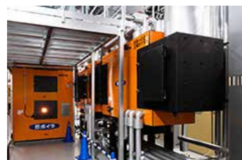
バイオマスボイラー （サントリー天然水 北アルプス信濃の森工場）
