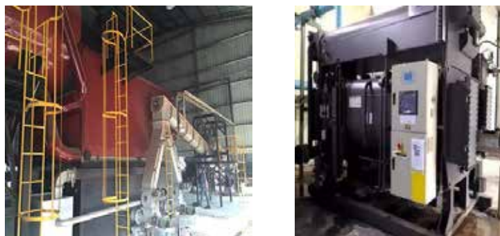
気候変動の影響を低減するために吸収式冷凍機とバイオマス・ボイラーを設置
