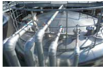
清浄レベルごとに回収した 水を200トンのタンクに貯蔵し再利用
