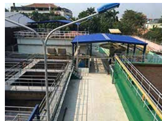
廃水処理プラント
