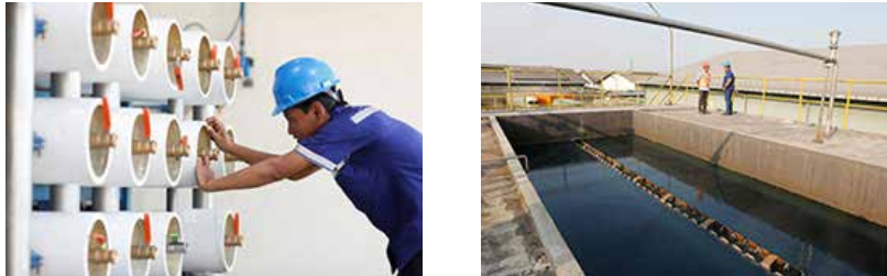
全てのSGB工場に導入されている廃水処理設備
