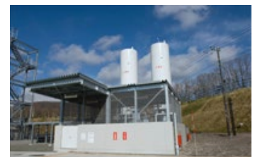
サントリープロダクツ（株）天然水奥大山ブナの森工場の液化天然ガス施設
