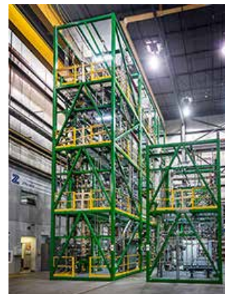
実証プラントの一部
