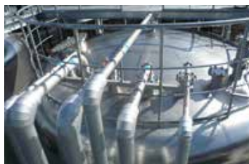
清浄レベルごとに回収した 水を200トンのタンクに貯蔵し再利用
