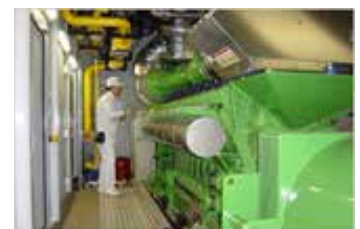
利根川ビール工場の コジェネレーションシステム
