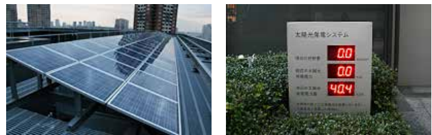
お台場オフィスの太陽光発電システム
