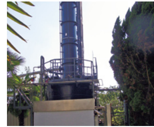
生物脱硫装置
