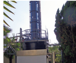
生物脱硫装置
