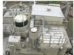
木曾川工場の嫌気性排水処理設備
