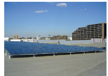
商品開発センターの太陽光パネル
