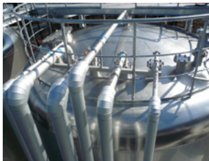
回収した水の貯蔵タンク
