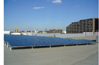
商品開発センターの太陽光パネル
